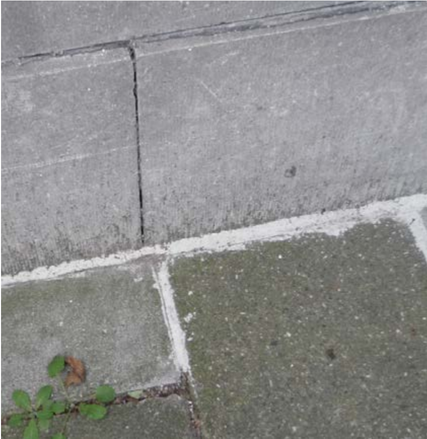
12. Een voorbeeld van de afdichting van de kier tussen de stoeptegels en de gevel, en tussen de stoeptegels.
